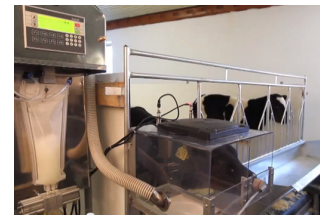
Installation av automatisk kraftfodertilldelning och mjölktilldelning
