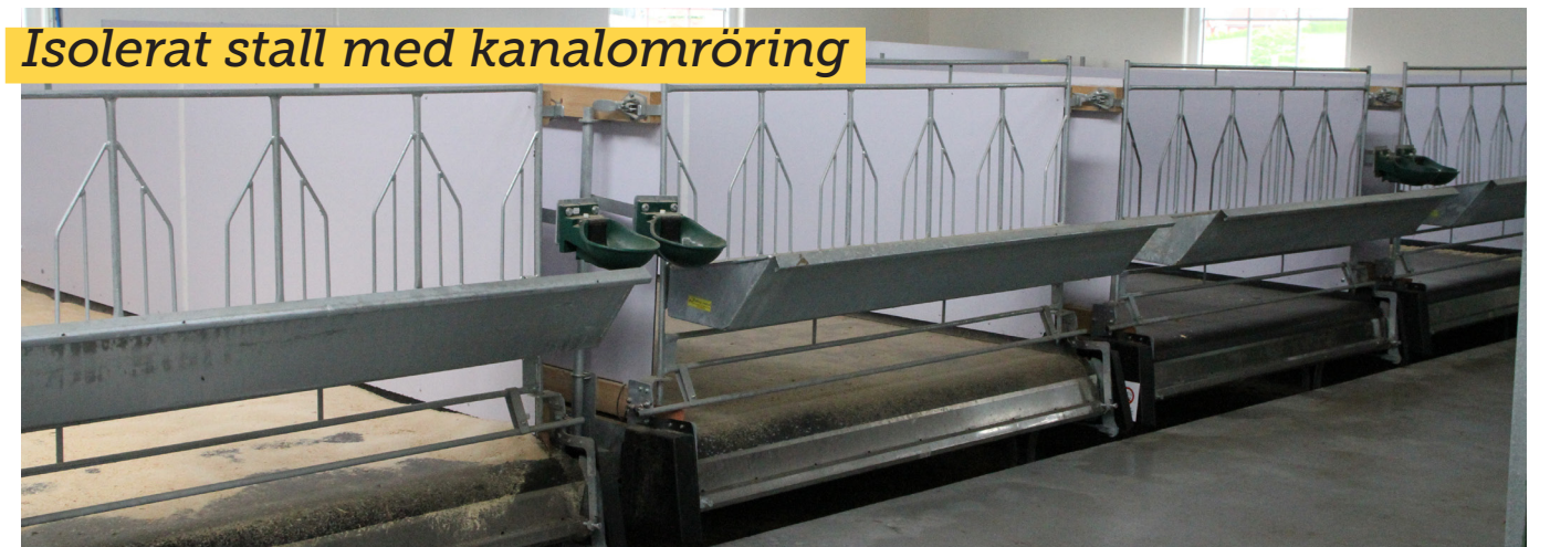
Gruppboxar installerade med kanalomröring.
